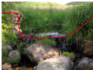
Profil du seuil avant intervention, présentant une chute d'environ 50cm.
